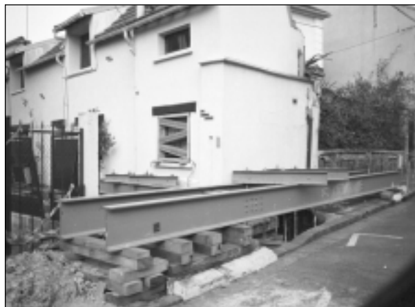
Figure 2 : l'effondrement a nécessité un sérieux étaiement de l'ouvrage.
